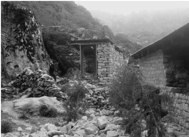
大地震で壊れた教室の外壁とトイレ
