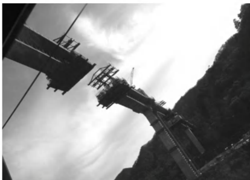
工事途中でストップしたままの橋脚
