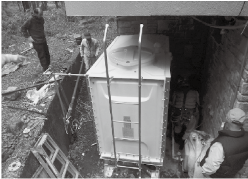
新しくなった受水槽
